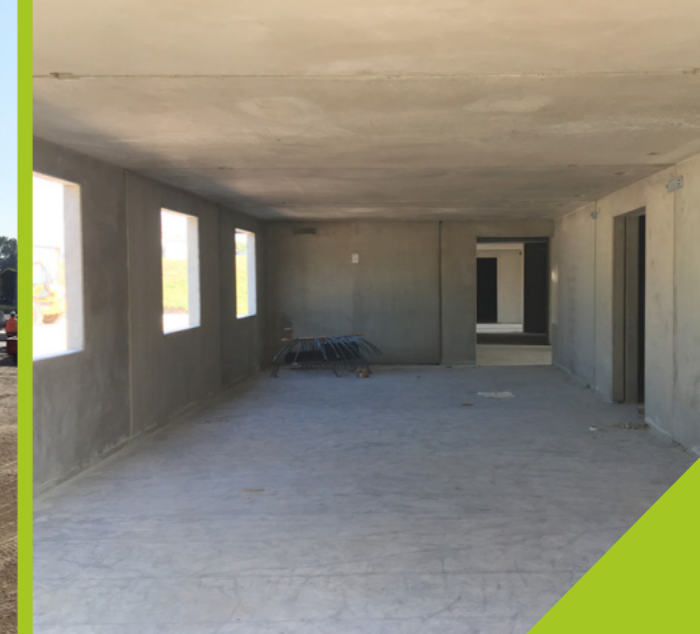
Wie ganz normale Räume erscheinen die mobilen Einheiten von innen – trotz der Fertigteilbauweise. (Bild: Modulo Wertstoffhöfe GmbH)
